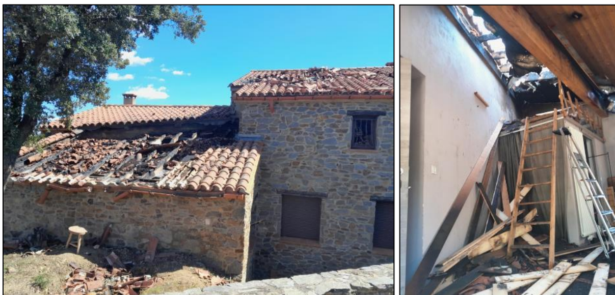
Dégâts intérieurs sans destruction de l'habitation (Mas Descosy - Castelnou)
